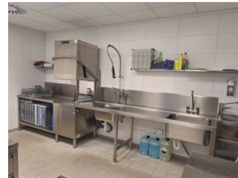
Die neue Küche mit großer Spülstraße.
